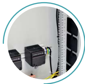
Ogrzewanie szafy grzałkami z termowentylatorem
