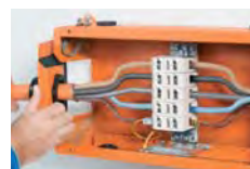
Dużo miejsca na okablowanie
