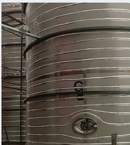
Ogrzewanie technologiczne zbiorników na płyn, Rumunia
