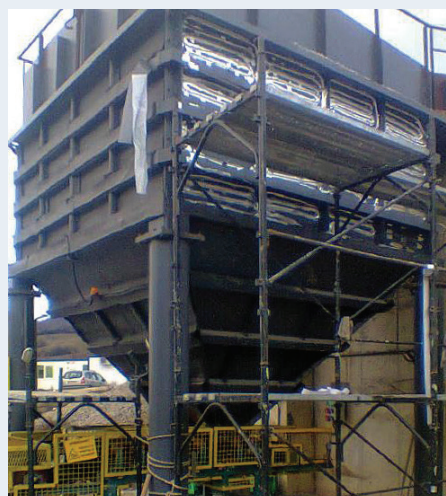
Ochrona zbiornika przed zamarzaniem, Bułgaria
