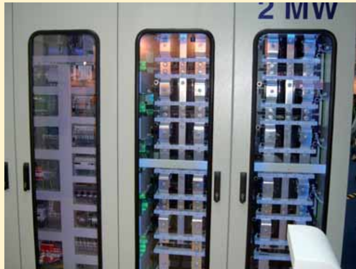
Zabezpieczenie półprzewodników wewnątrz przekształtnika średniego napięcia.
