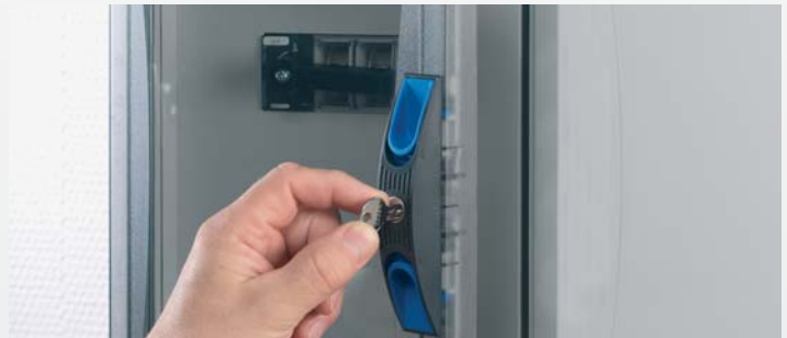
Obsługa aparatów po otwarciu drzwi, dodatkowa osłona części pod napięciem
