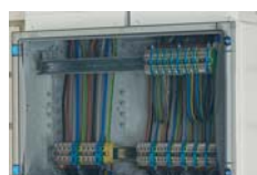
Szyny nośne do zacisków rządowych
