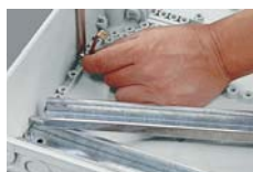
Montaż aparatury na szynie nośnej
