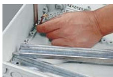
Montaż aparatury na szynie nośnej
