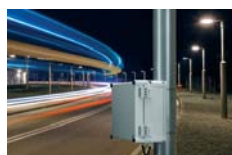
Skrzynka sterująca sygnalizacją świetlną
