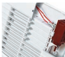
Wentylator nie pracuje – żaluzja jest zamknięta
