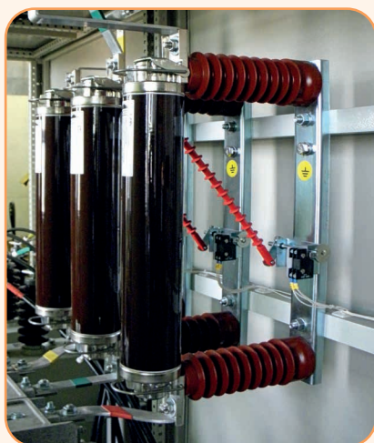
Położenie podstaw bezpiecznikowych i wkładek topikowych zamontowanych wewnątrz.
