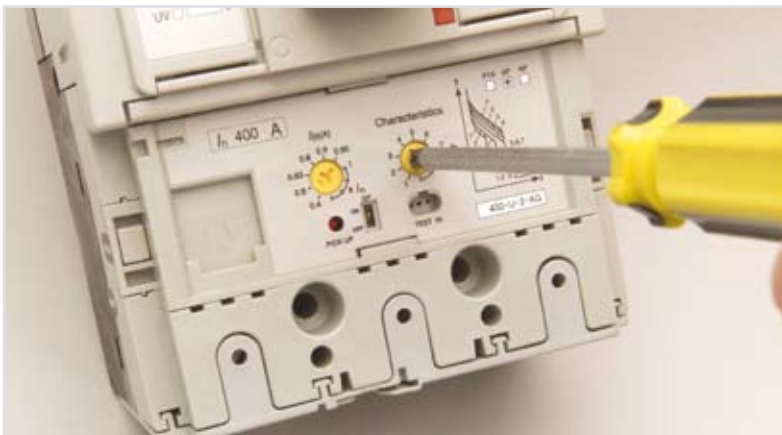
Wybór charakterystyki w wyłączniku 400A z zabezpieczeniem elektronicznym
