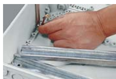
Montaż aparatury na szynie nośnej
